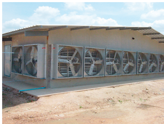
Рис 4.3: Пример автоматической вентиляции
